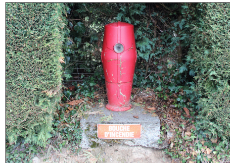
Bouche d'incendie à Entrecolles - Source : 6t 2018
